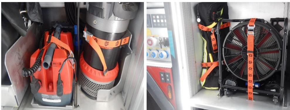
20. és 21. számú képek. Elektromos működtetésű szivattyú, mobil kárhelyreflektor és túlnyomásos ventilátor a málhaterekben. (Pántya Péter, 2022)
