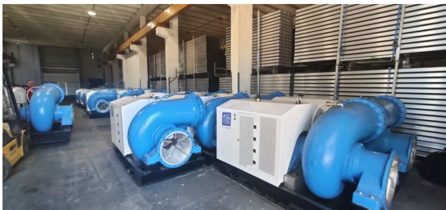
27. ábra: ATIVIZIG ASG hordozható szivattyú és mobil árvízvédelmi falak, Bencs Miklós, 2022.
